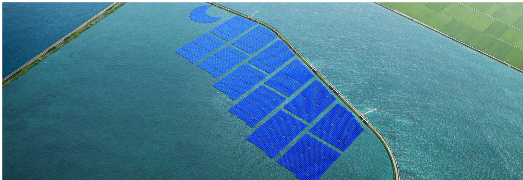
高兴湖水上太阳能发电站
